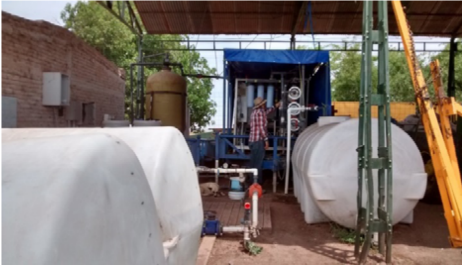
Figura 6. Planta desalinizadora de oi con capacidad de 150 m 3 /d.
