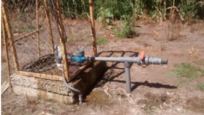
Figura 7. Pozo de alimentación, con bomba trifásica de 3 HP y 3540 RPM.
